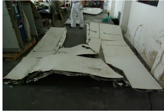
Figure 39 : plafond du module de repos PNC : déformation du haut vers le bas
